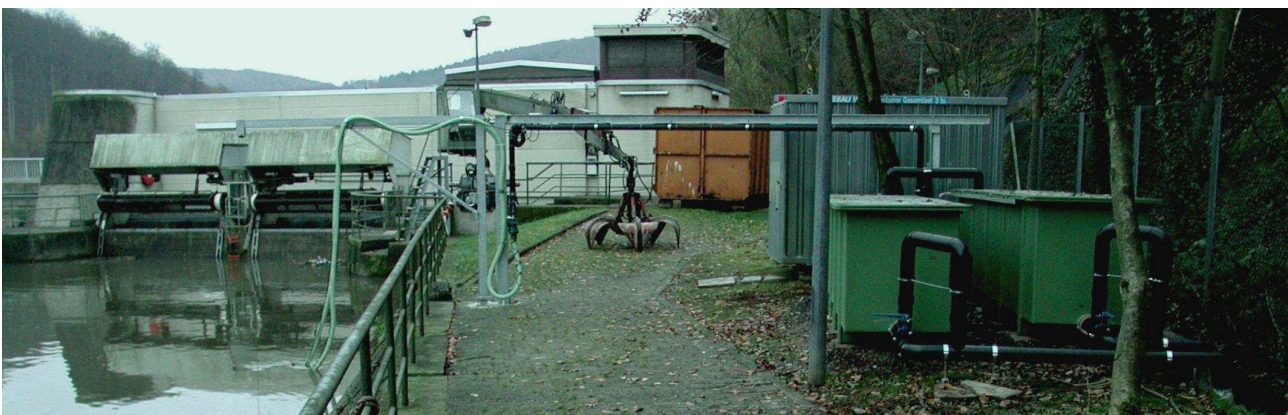
Abb. 30: MIGROMAT® am Wasserkraftstandort Wahnhausen an der Fulda mit zwei Hältertanks, Wasserzu- und -ableitung
