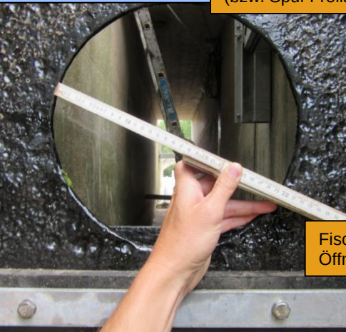
Fischabstiegs-Schacht mit Bremswehr (bzw. Spül-Freilauf)
