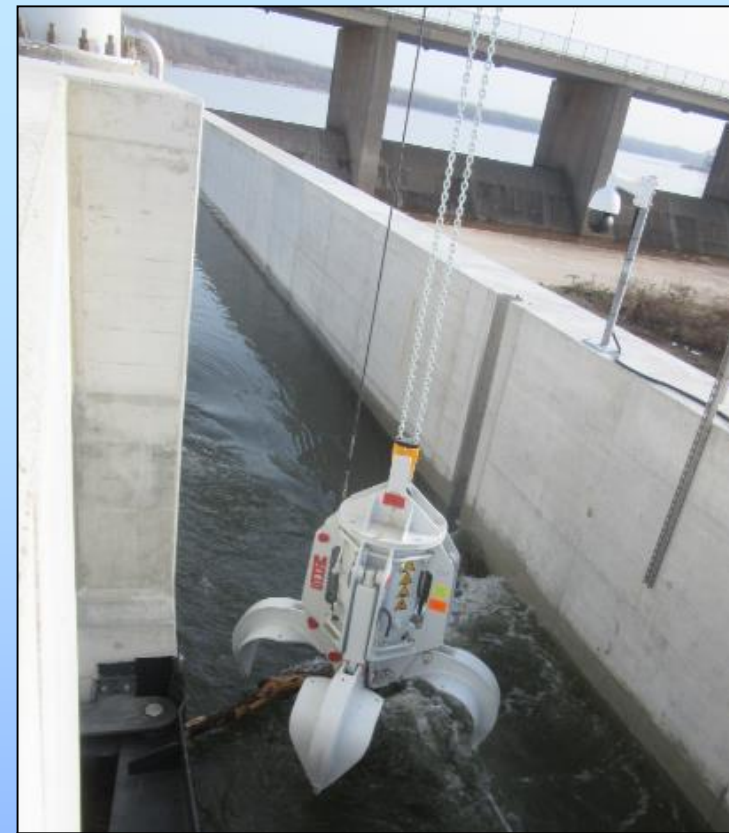
Greifer für sperriges Treibgut vor Einlauftr im Fischabstiegs-, Treibgut-, Mindestwasser- Schacht
