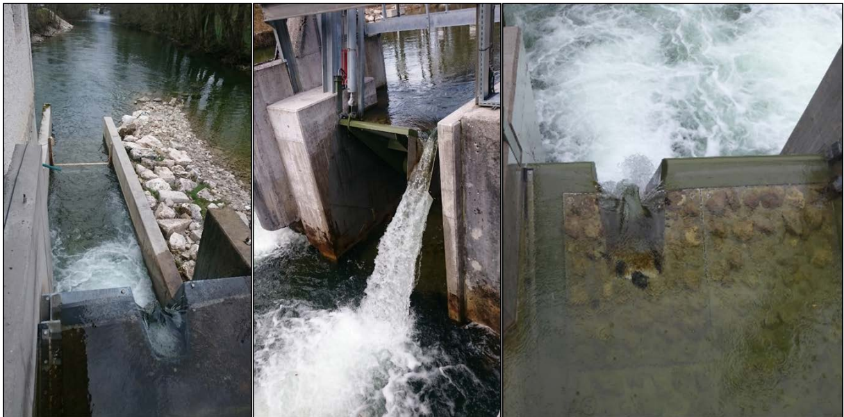
Abbildung 3: Abstiegsanlagen an den Kraftwerken Laganda (links) und Ebewe (Mitte und rechts) in der Seeache.
